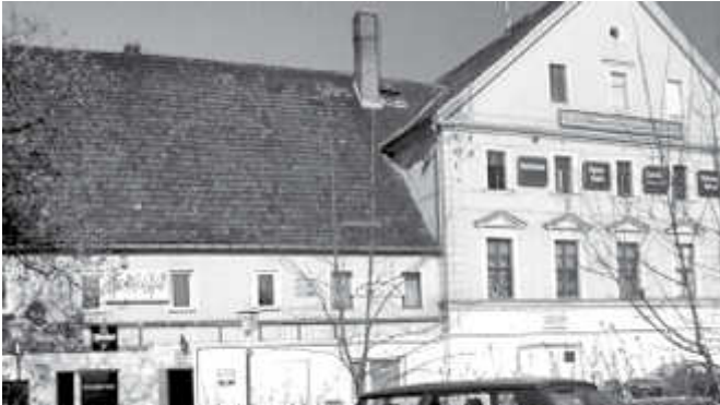
Der Gasthof im Jahre 2002 mit neuem Fassadenanstrich. Deutlich ist aber auch das reparaturbedürftige Dach zu erkennen.
